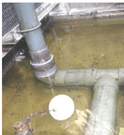
CALFA "SEP" 「設置済み」 冷却塔内部
